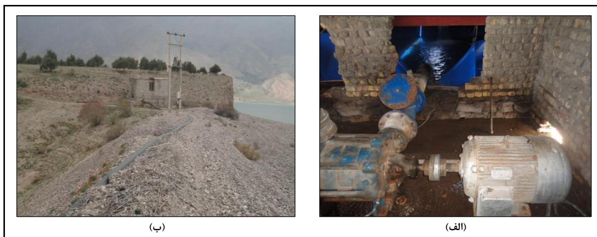
شکل ۱- ایستگاه پمپاژ ثانویه (الف) و ایستگاه پمپاژ اولیه (ب) در سامانه آبیاری مورد مطالعه
